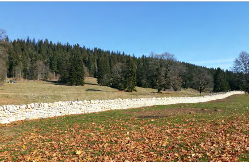
Photo 3: centinaia di metri di muri a secco vengono ricostruiti lungo il sentiero „Chemin des pionniers“ (comune di Val-de-Ruz NE) (photo: © SL-FP)
