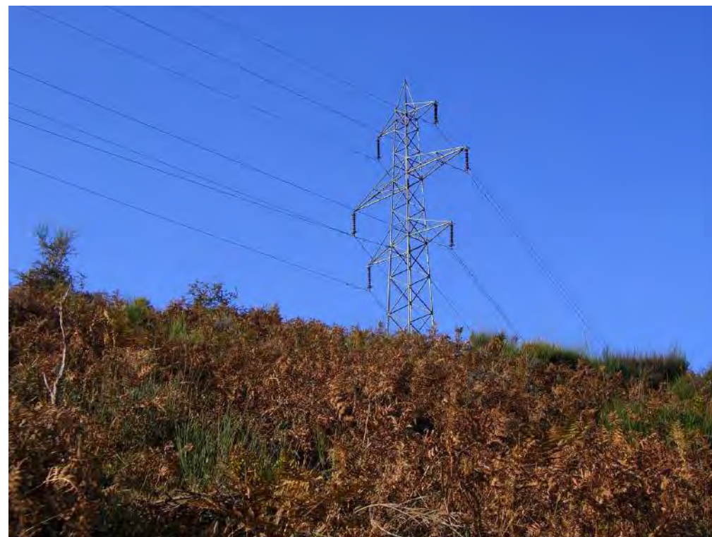
Tralici tra Losone e Ronco sopra Ascona
