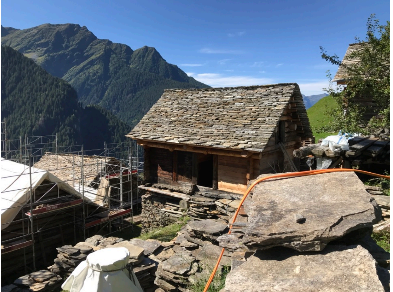
Photo 1: Le hameau remarquable de Germanionico pendant les travaux de restauration (photo: © Karina Liechti, SL-FP)
